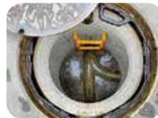
通常のマンホール
