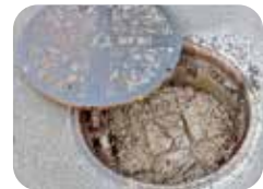
油により閉塞したマンホール
