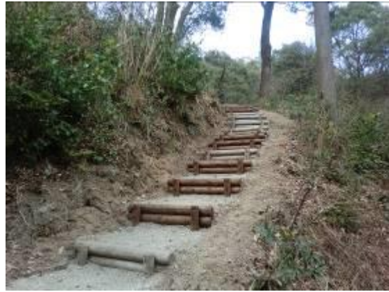
腐食した階段の整備
