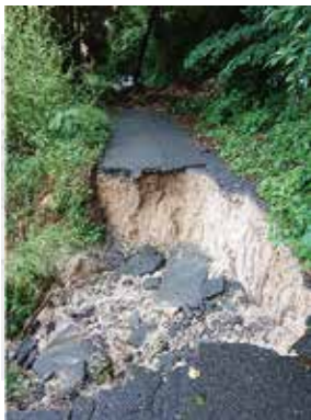
豪雨直後の市道 河内・大峠線の様子
