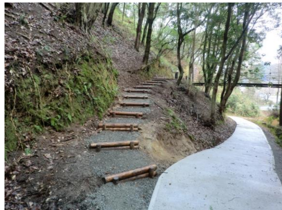
腐食階段、荒れた遊歩道の整備
