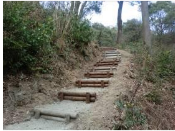
腐食した階段の整備
