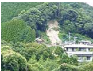
《神辺町上の車グリーンタウン法面崩壊》
