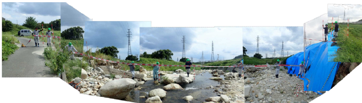
蔵上井堰 被災状況
