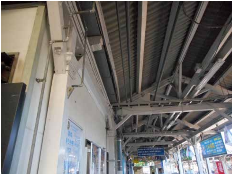
写真 3-21 本屋下屋とプラットフォーム上屋の取り合い 谷樋が設けられている
