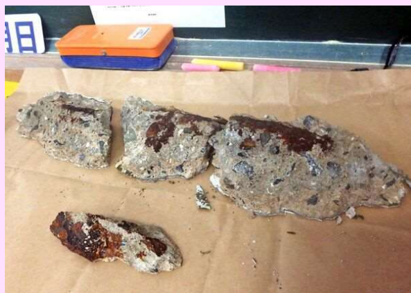
コンクリート剥離
