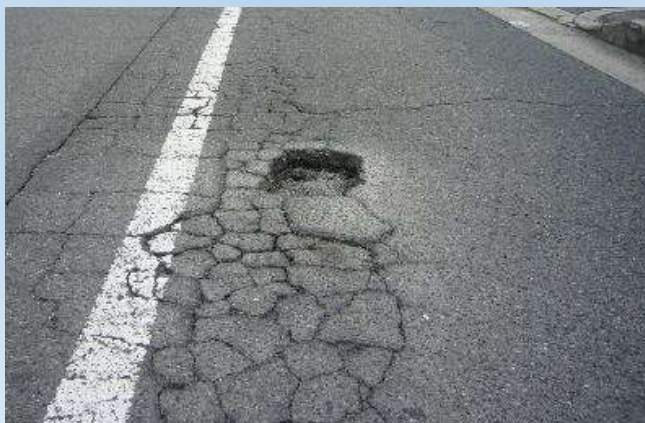
道路陥没状況例
