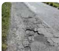
道路のひび割れ
