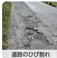
道路のひび割れ
