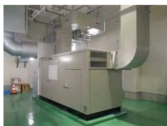
自家発電設備
