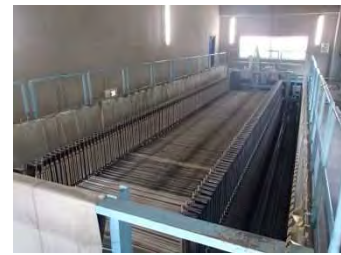
機械脱水設備
