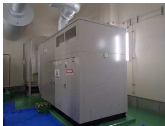
自家発電設備
