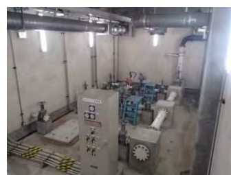
北部送水ポンプ
