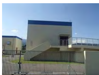
送水ポンプ棟
