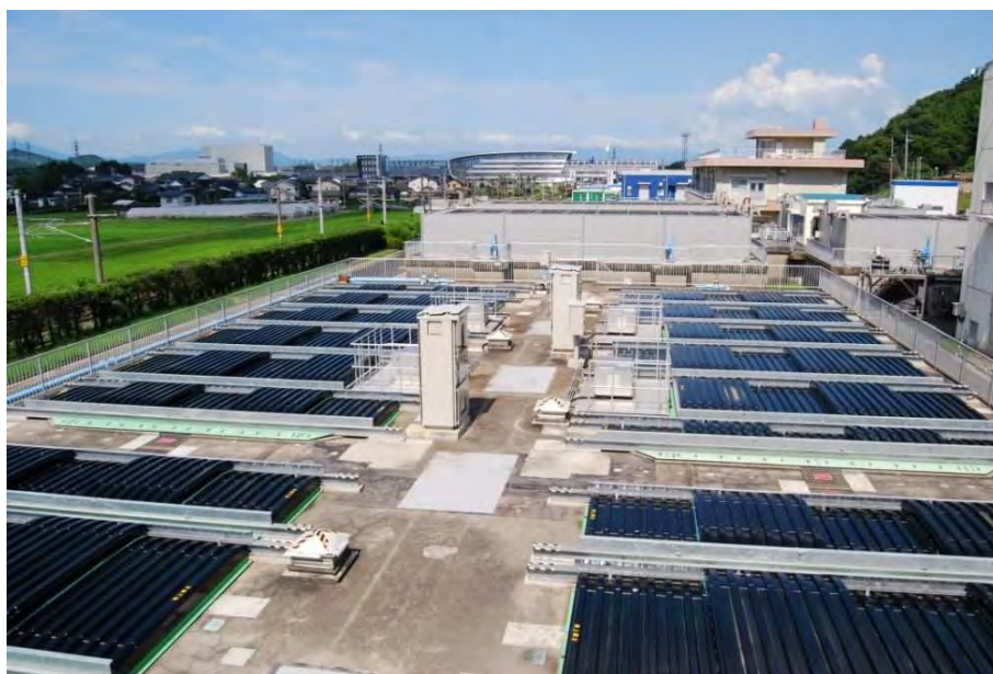
鳥栖市浄水場
