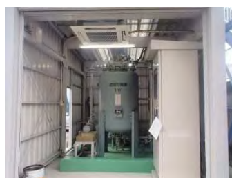
硫酸注入施設
