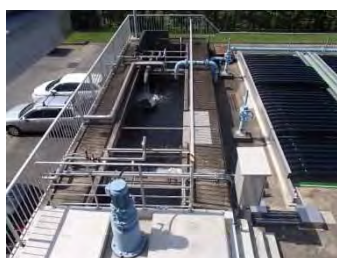
着水井・急速攪拌機
