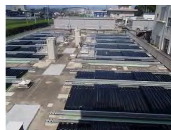
フロック形成池・薬品沈殿池
