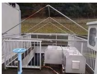
中塩素混和池
