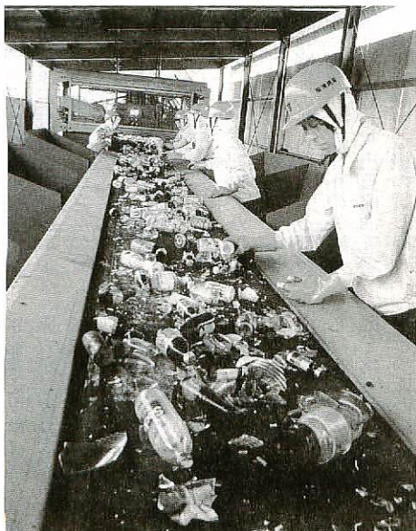
不燃物選別機(年金積立金還元融資施設)
