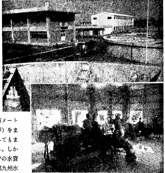
上…安楽寺町の新宝満川ぞいに完成した東部工業用水の浄水場 下…内部の送水ポンプ
