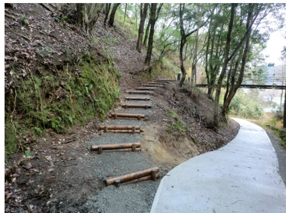
腐食階段、荒れた遊歩道の整備
