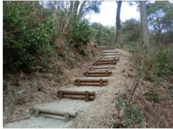
腐食した階段の整備
