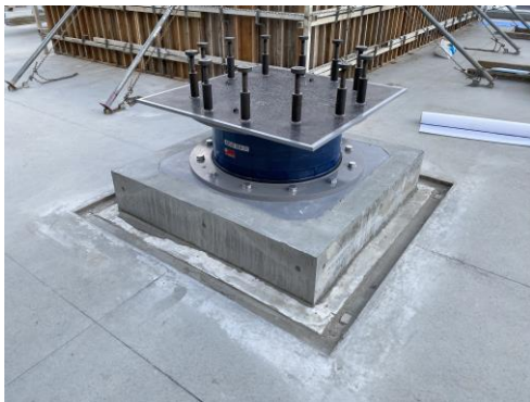
免震装置を設置しています。
